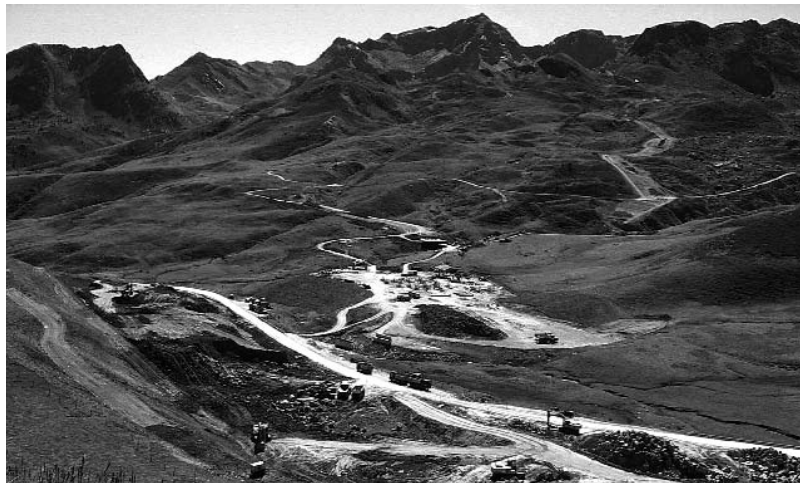
RESERVA AMENAZADA. El valle de Espelunciecha está afectado por las obras de la estación de Formigal (Huesca).
